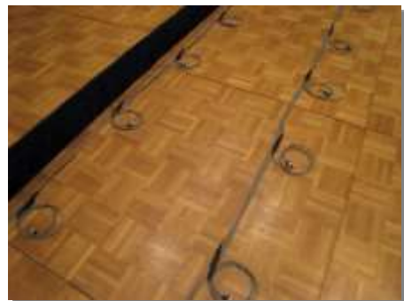
足元配線コードとボタン
