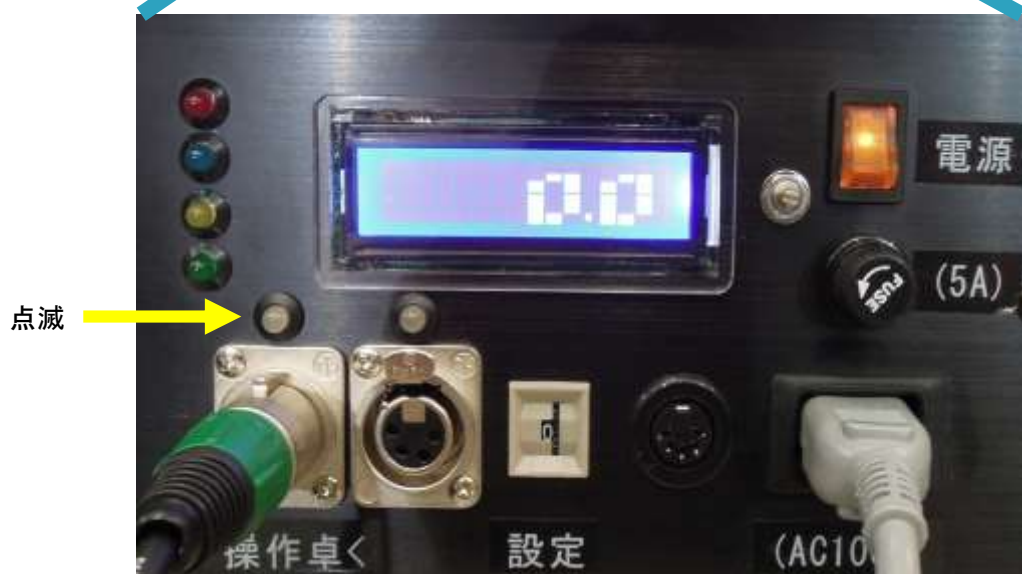
【表示機の接続パネル】
